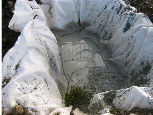
Figure C : Fosse de récupération des produits de nettoyage des camions toupies, munie d'un géotextile filtre
